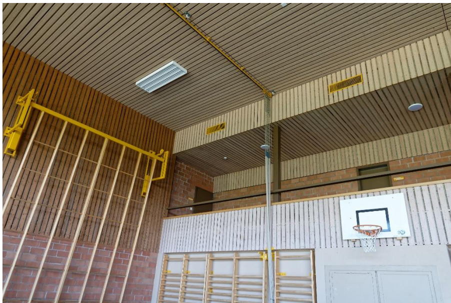
Figure 24 : Intérieur de la Salle de Sport. On remarque les bouches de récupération d'air et l'éclairage LED.
